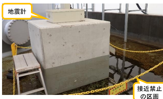
(写真6) 地震計の設置状況
