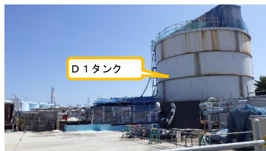
(写真1-2) D1タンクの状況②
