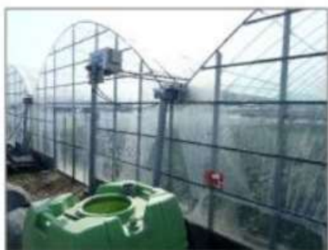
防犯カメラの設置
