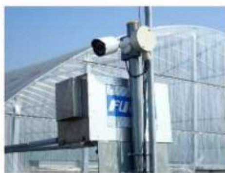
防犯カメラの設置
