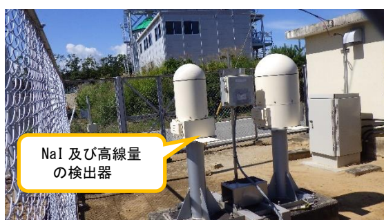
(写真 4－1) モニタリングポスト No. 3の設置状況
