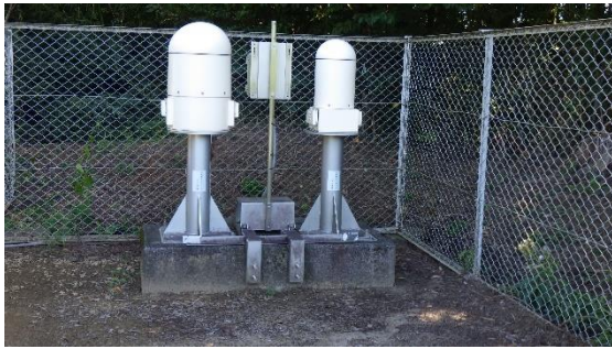
(写真４－２) モニタリングポスト No. ４の設置状況
