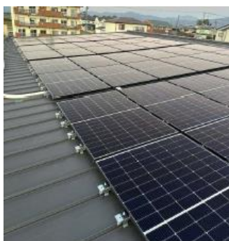
坂下電子光学（株）工場に設置された太陽光発電設備 （提供：坂下電子光学（株））
