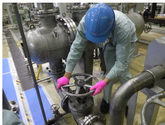
ループ設備操作の様子
