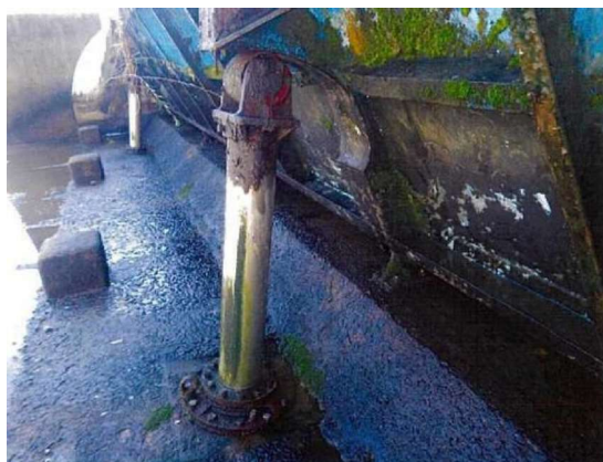
ゲート整備補修 (扉体塗装、水密ゴム鋼管、油圧シリンダー交換) (施工前) 愛宕堰頭首工(伊達市)
