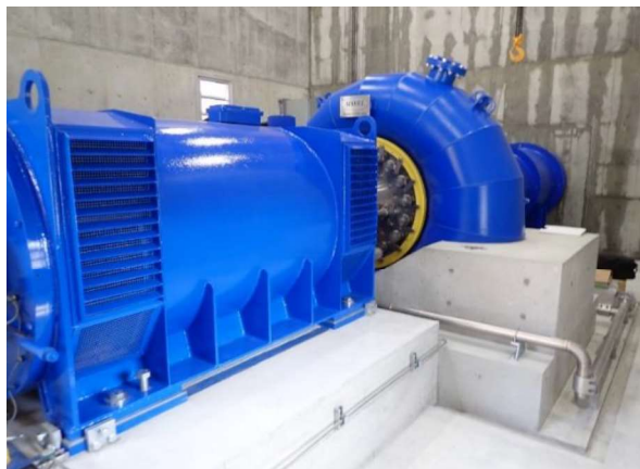
令和６年度より発電を開始した 「請戸川水力発電所（浪江町）」
