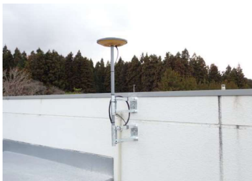
RTK基地局のGNSSアンテナ
