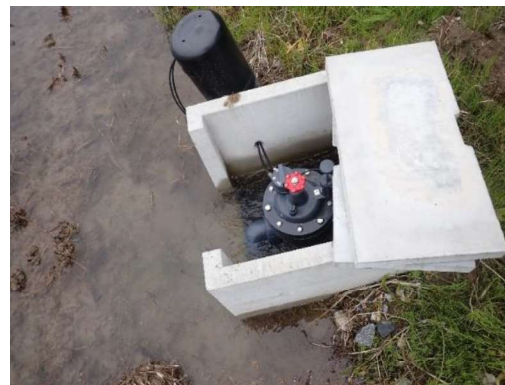
矢川原区における自動給水栓設置状況 (南相馬市原町区)
