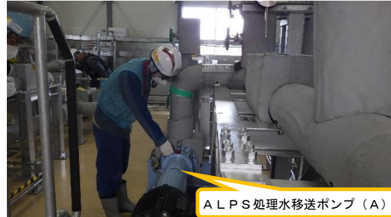
(写真2②) ポンプの稼働状況
