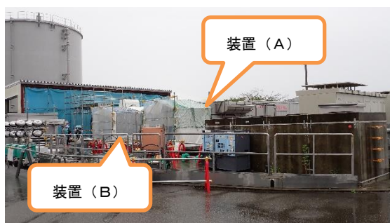
（写真1－1） 窒素ガス分離装置のエリア概観
