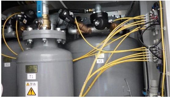
(写真 1－3) 窒素ガス分離装置の構成の一例 (写真は活性炭槽)
