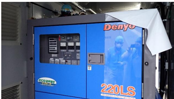
(写真 1－5) 非常用ディーゼル発電機(B)の状況
