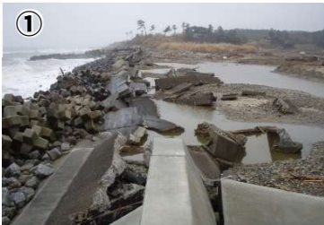
▲津波による堤防の被害
