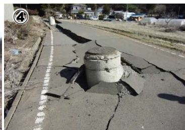
▲地震による液状化現象
