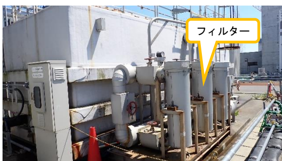
(写真 2) ブライン浄化設備の設置状況
