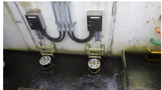
(写真 2 ③) D 排水路放射能測定装置
