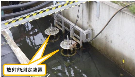
(写真 1 ③) 物揚場排水路放射能測定装置
