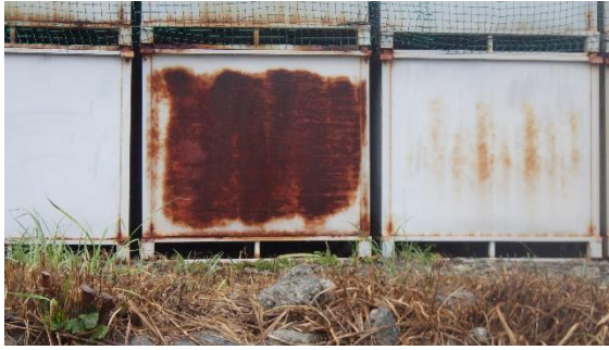
(写真 2) 錆が生じているコンテナ
