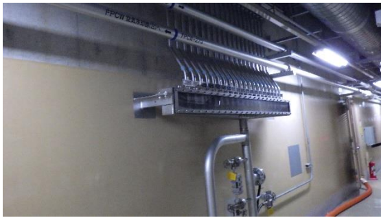
(写真 5－1) 使用済燃料共用プール漏えい目視箱 の設置状況①
