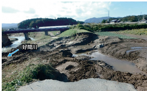
好間川 河川堤防決壊（いわき市好間町今新田）
