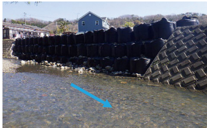
藤原川（常磐藤原町別所） 被災状況
