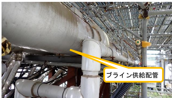
(写真 1－3) ブライン供給移管（6 B L K、3 号 機西側）の状況
