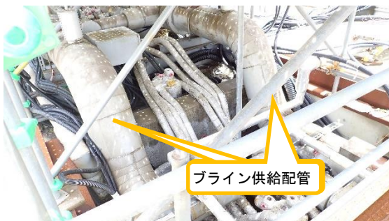
(写真 1－4) ブライン供給移管（7 B L K、4 号 機西側）の状況
