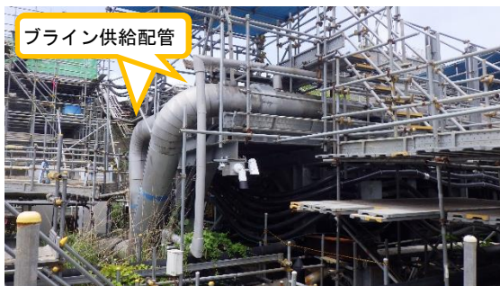
(写真 1－2) ブライン供給移管（5 B L K、1 号 機西側）の状況
