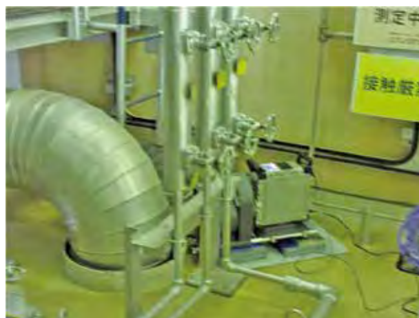
汚染状況調査（東京電力提供）
