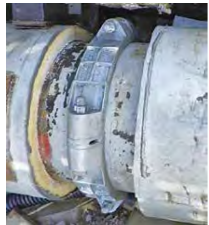
ブライン（不凍液）が漏えいしたカップリングジョイント部
