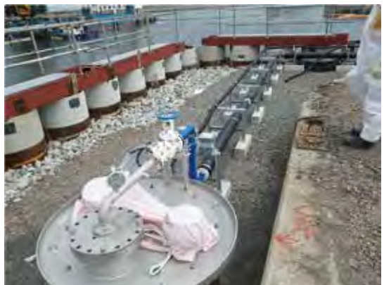
海側遮水壁と地下水ドレンpond
