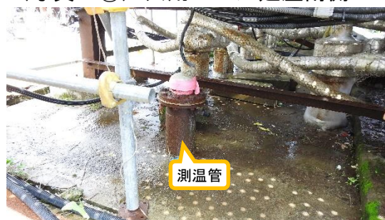
(写真 5 ①) 温度が上昇した測温管
