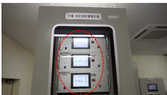
(写真 2 - 2) 金属廃棄物減容室の管理運用状況② (計量及び各室線量のデータは、 一元管理されている。)
