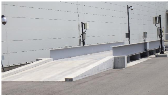
(写真 1 - 1) 減容処理設備の現況① (トラックスケール：廃棄物の計量 及び線量を測定)
