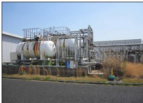
3号炉 薬液タンク
