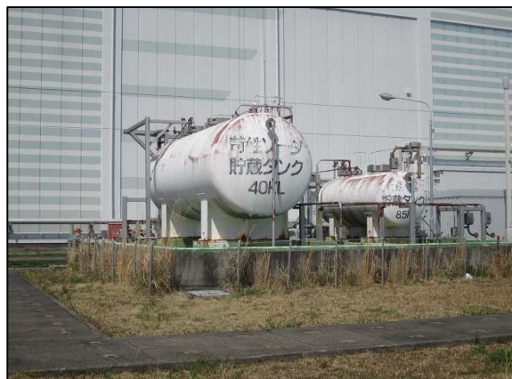
4号炉 薬液タンク
