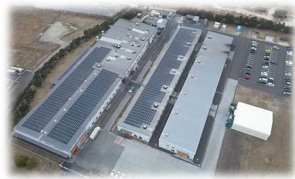
東北三之橋相馬工場 太陽光発電設備（438.25kW）
