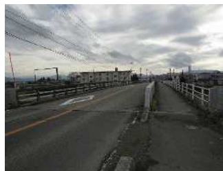
②補修箇所の確認
