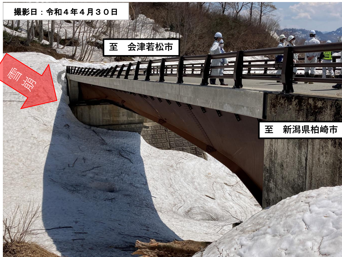
令和4年の雪崩被災により山側の桁が被災を受けた
