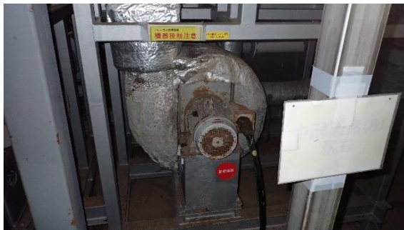
(写真 3-2) 排気ファンの設置状況②
