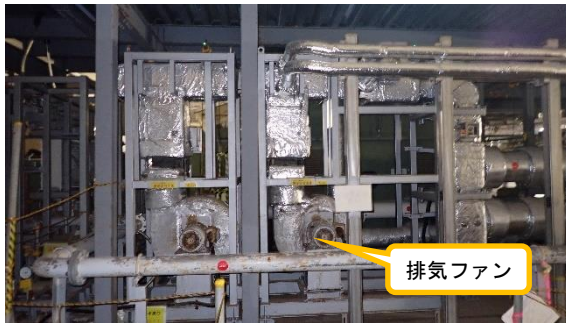
(写真 3-1) 排気ファンの設置状況①
