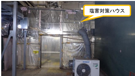
(写真1-1) 塩害対策ハウスの設置状況 ※ハウス内に重要設備が設置されている
