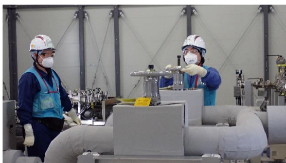
(写真1③) 移送設備建屋での弁操作
