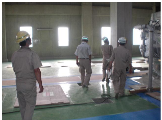
処理場「汚泥処理棟内NO. 3脱水機」
