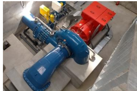
信夫山・光大寺小水力発電所（水車発電機） （信夫山福島電力（株））
