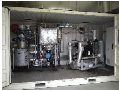
木質ペレットガス化熱電併給装置（提供：(株) シーズ）
