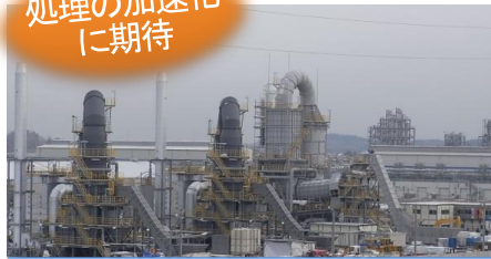
平成25年2月20日に始動した相馬市仮設焼却炉
