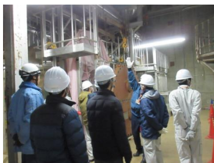
海水熱交換機建屋の様子
