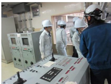
燃料取替室の様子
