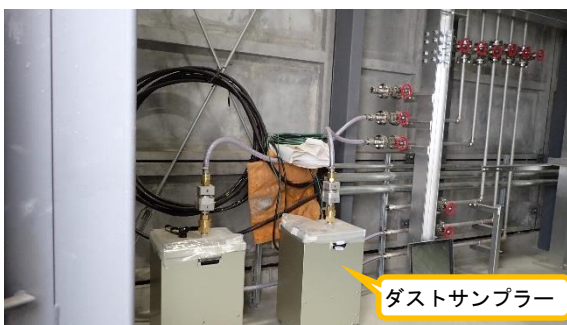
(写真4) 排気設備建屋内の状況② ※ダストサンプラーが設置されている
