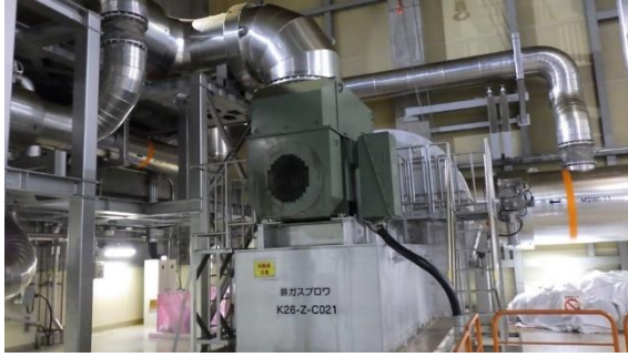
(写真 4 - 2) 廃棄物供給室外の設備機器の状況② ※写真は排ガスブロア
