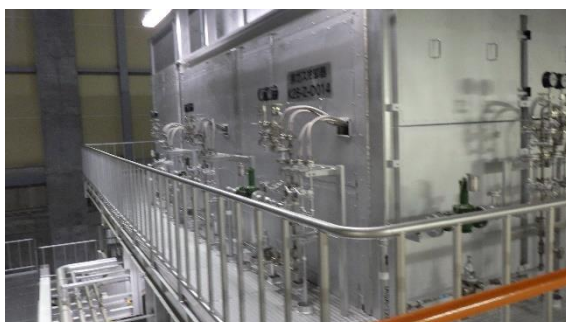
(写真4-1) 廃棄物供給室外の設備機器の状況① ※写真はガス冷却器
