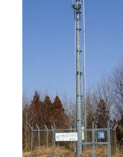
航空障害灯(OBL) 水平表面から突出している地形の位置を示すための灯火です。(場外)
