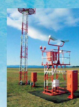
T-DME 着陸のため進入中の航空機に対し接地点からの距離を示す装置です。
