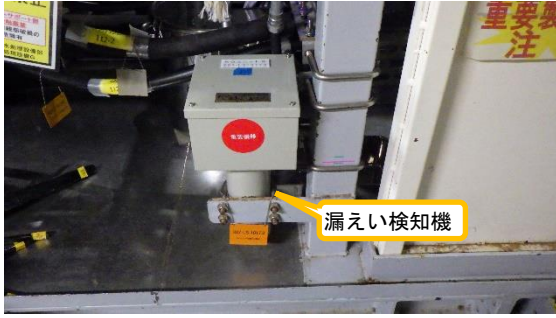
(写真 2 - 2) 漏えい検知機の設置状況
