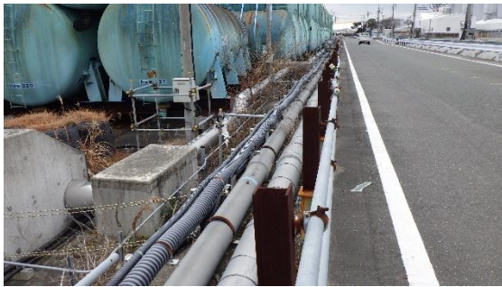
(写真 2-2) D排水路の集水エリア④ (横型ブルータンク保管エリアC 脇の配管等)
