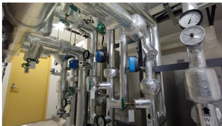
猪苗代町統合中学校地中熱利用ヒートポンプ（提供：猪苗代町）
