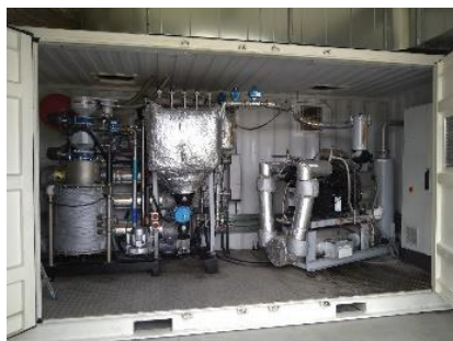
木質ペレットガス化熱電併給装置（提供：(株) シーズ）
