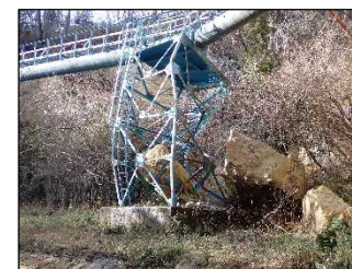
【復旧前】 （管路・橋脚が破損）
