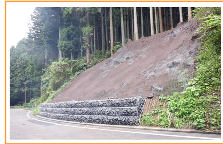
被災した林道法面の復旧
