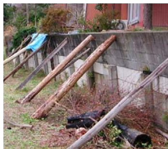
頬杖による擁壁倒壊防護
