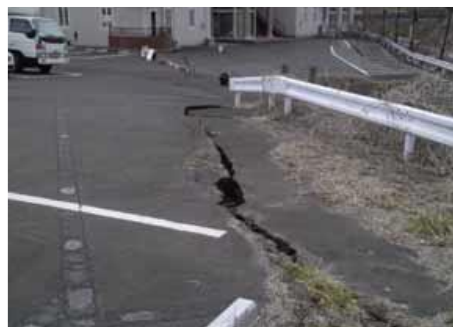
(b)のり肩の亀裂
