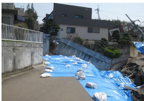
(c)腹付け盛土の崩壊
