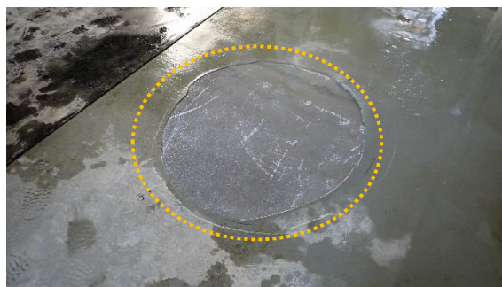
(写真1②)切除された防水シート
