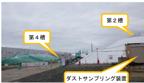
(写真1-1) 第2槽及び第4槽の状況① (第2槽は、3層構造の覆土状態を維持。第2槽と第4槽の間にダストサンプリングの採取口が設けられている。)
