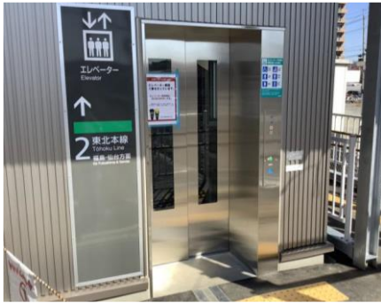
(エレベーター)
