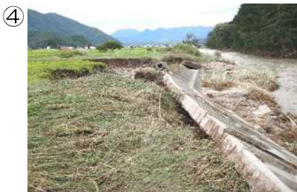
④ 福米沢地内 越水による破堤及び背後地への浸水痕跡
