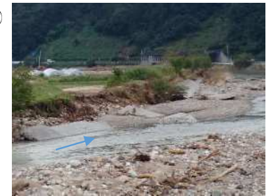
伊予戸地内の護岸流出状況
