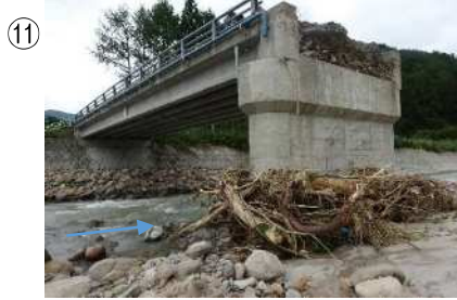
⑪ 静川地内 出合橋が落橋
