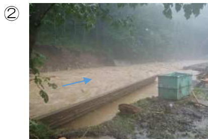
② 越水によりブロック積み背後が浸食される
