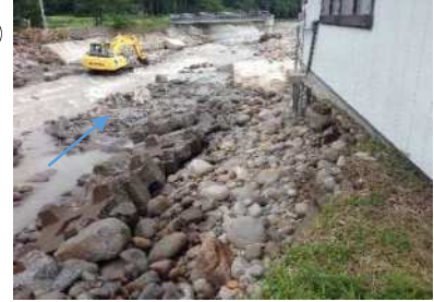
⑫ 静川地内 家屋の基礎部が浸食される
