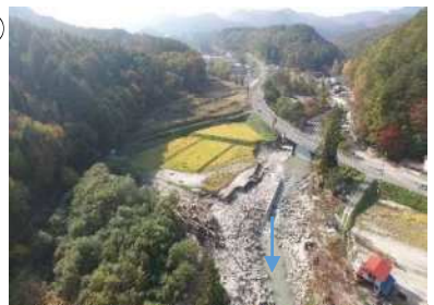
⑮ 針生地内 下針生橋から下流側の浸食状況
