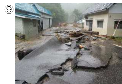
⑨ 越水した水がアスファルト舗装の下を流れたことによる路面状況
