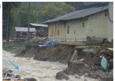
⑱ 針生地内 木材工場の基礎部が浸食される
