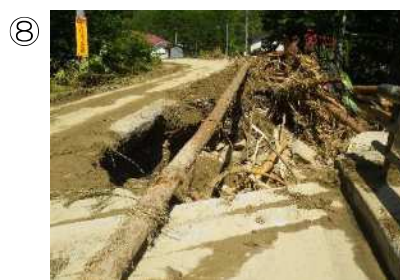
⑧ 新田橋橋台背後の洗掘状況
