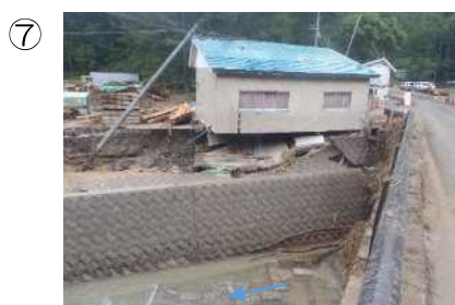
⑦ 建物の基礎部が浸食される
