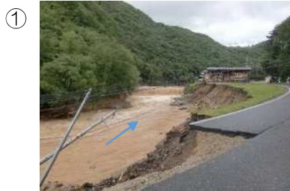
① 侵食により国道 352 号が崩落
