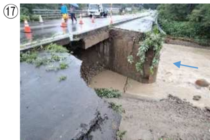
⑰ 黒森沢橋橋台の裏側が洗掘され歩道が崩落
