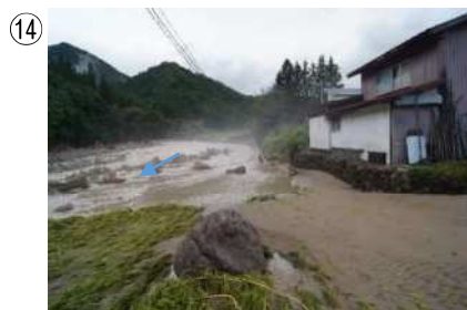
⑭ 十本木地内 家屋の浸食被害
