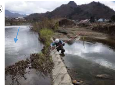
越水により護岸の裏側が流出した
