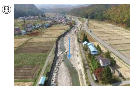
⑧ 静川地内 高橋下流の護岸の侵食状況（ドローン撮影）
