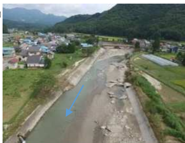
館岩川の越水による破堤状況(ドローン撮影)
