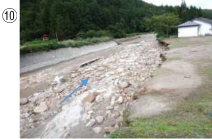
⑩ 静川地内 黒沢集会所の上流側が浸食被害を受ける
