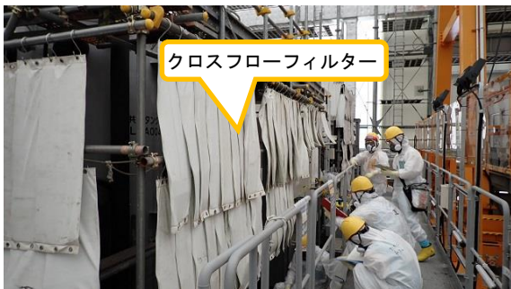
(写真1) クロスフローフィルターの復旧作業の状況 ※クロスフローフィルターは被ばくを低減するために遮蔽シートで覆われている。
