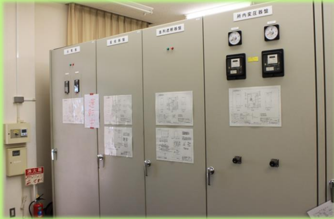
日中発電所 制御盤
