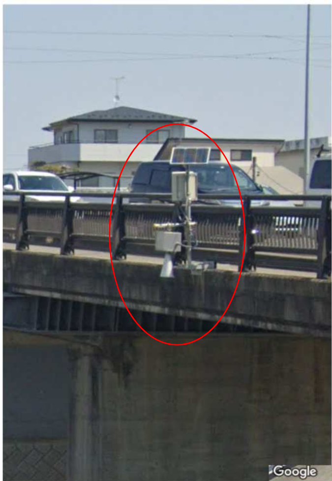
水位計の設置状況 ＜逢瀬川（逢瀬橋）・郡山市＞
