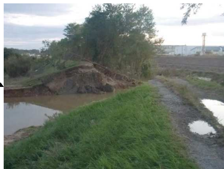
出典：令和元年台風19号災害の概要 福島県県中建設事務所 谷田川破堤箇所(2.5km左岸)
