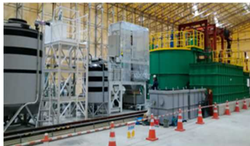
洗浄工程設備
