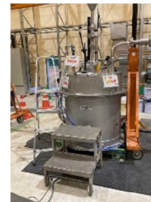
安定化工程設備 (3設備のうちの1設備)
