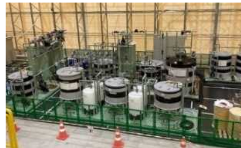
吸着工程設備 (3設備のうちの1設備)
