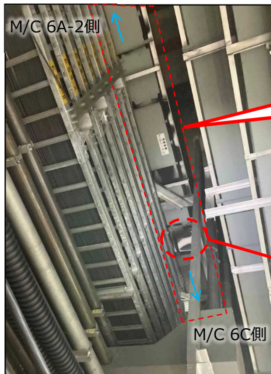
相非分割母線(見上げた状況)
