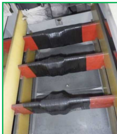
事故点より北へ約9m 箇所内部写真
